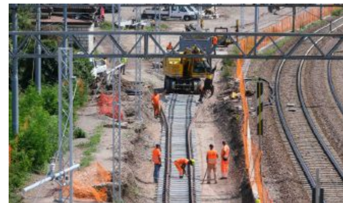
Lavori in corso Il cantiere del bypass allo Scalo Filzi © Foto Marco Loss
